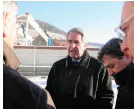
La visite a commencé par le chantier du cinéma en cours de construction.
